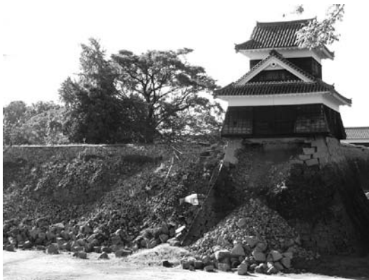
石垣の一部が崩れた熊本城櫓
